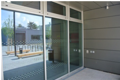
Kartenleser neben der Glasfassade in der Wand
